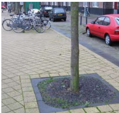
Zaandammerplein in Amsterdam, boomspiegel met Epoxy. Sinds najaar 2004. Mulder: "Binnen een jaar stond hier alweer veel onkruidgroei. Waarom dat gebeurt, is niet helemaal duidelijk. Ook is boomtechnische controle op rot bij de stamvoet niet goed mogelijk omdat de Epoxy vaak te dicht rond de stam is aangebracht."
