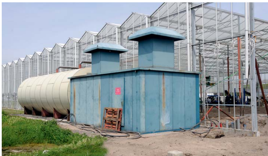
Een warmte-kracht-koppeling kan onder de EIA-regeling
