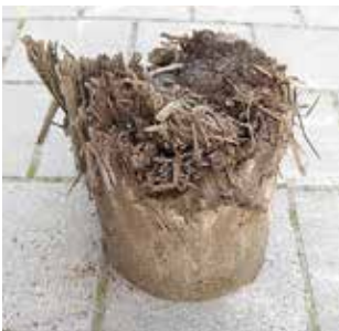
De kop van een rotte paal zoals die onder de woning vandaan is gekomen
