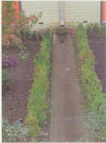
In deze goot blijft het water staan.
