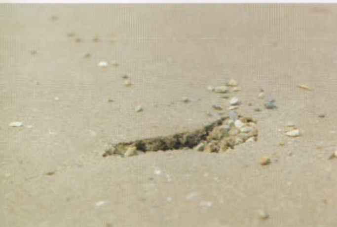
Reeds na drie maanden had de verharding van vezels, zand en epoxyhars diverse beschadigingen. Ook een dikkere laag gaf beschadigingen.
