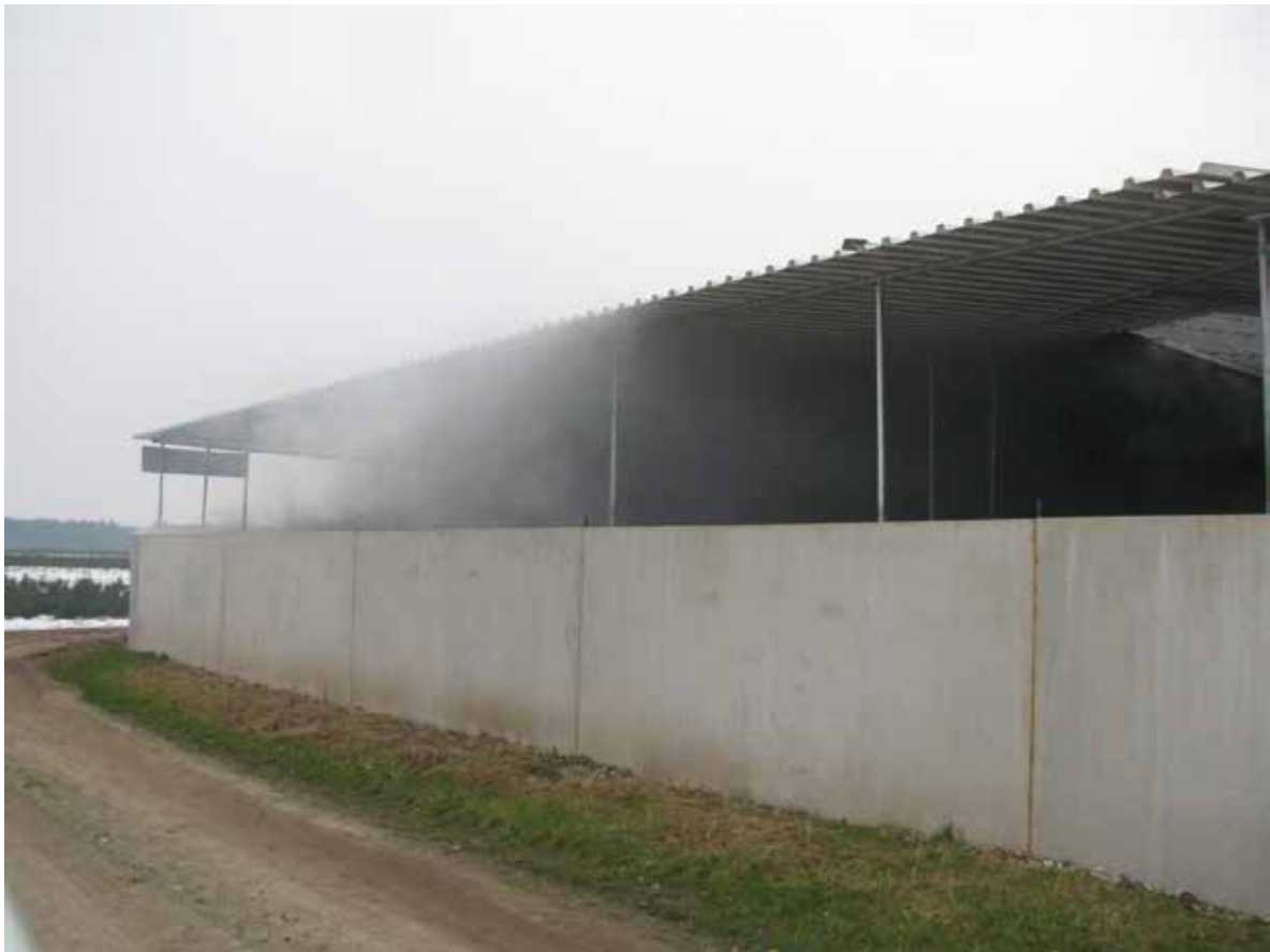
Figuur 2.5. Buitenaanzicht van het biofilter.
