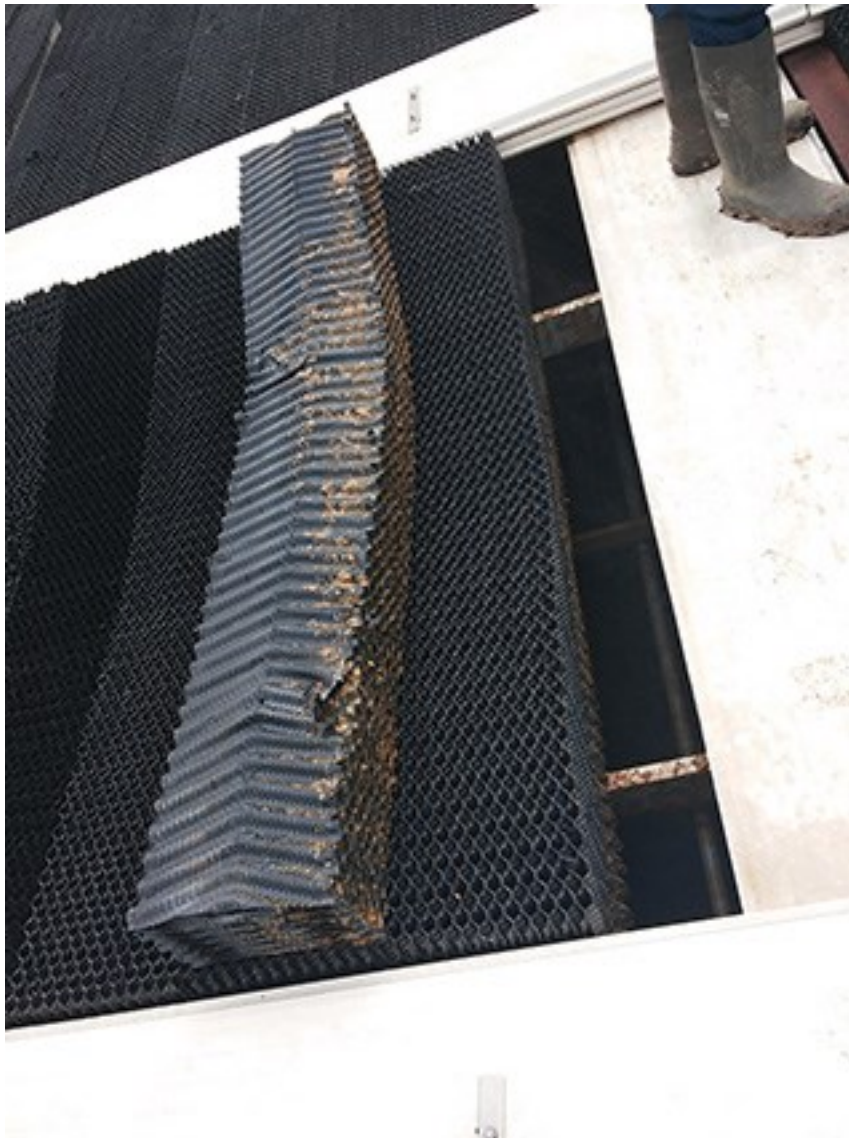
Figuur 13 Bovenaanzicht van de luchtuitlaat van de biologische luchtwasser; het zwarte kunstofpakket is de druppelvanger. Eén van de druppelvangermodules is verwijderd en ligt op zijn kant op de andere druppelvangermodules. Op de verwijderde druppelvangermodule is geel-bruine biofilm zichtbaar (aan de kant waar de sproeiers zich bevinden).
