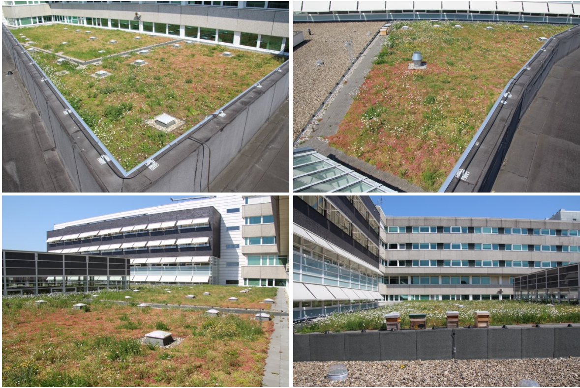
Figuur 3 Overzicht van het aanwezige groendak, situatie van 5 juni 2015, op Ziekenhuis Rivierenland. Foto's: Fabrice Ottburg©.
