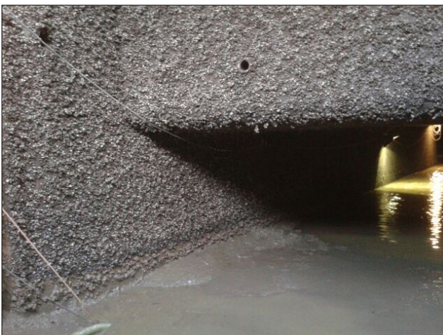
Figuur 16: Aankleving van Dreissena op boezemgemaal Gouda. Vanuit hier wordt het water vanuit de Hollandse IJssel het beheergebied van Rijnland ingelaten.
