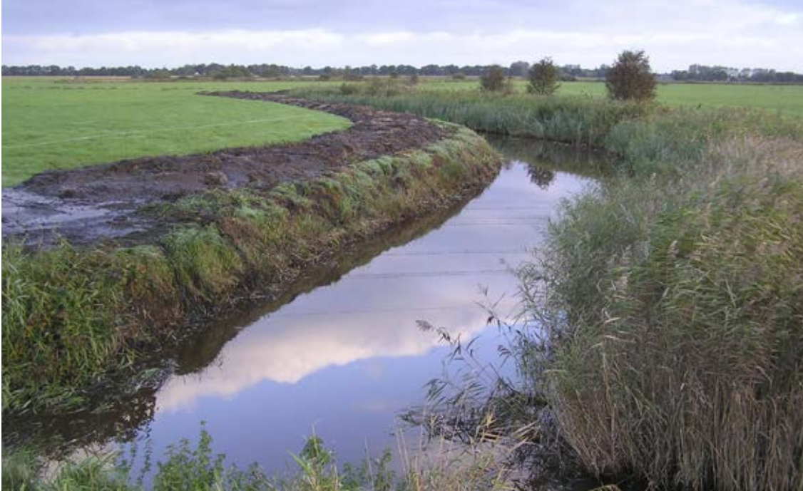
Groot onderhoud van een hoofdwatgang (oktober 2012) met eenzijdig een natuurvriendelijke oever, oktober 2012.
