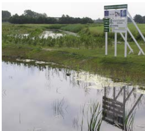
Aanleg EVZ in het traject van de Nieuwe Vaart nabij Gorredijk, juli 2006.
