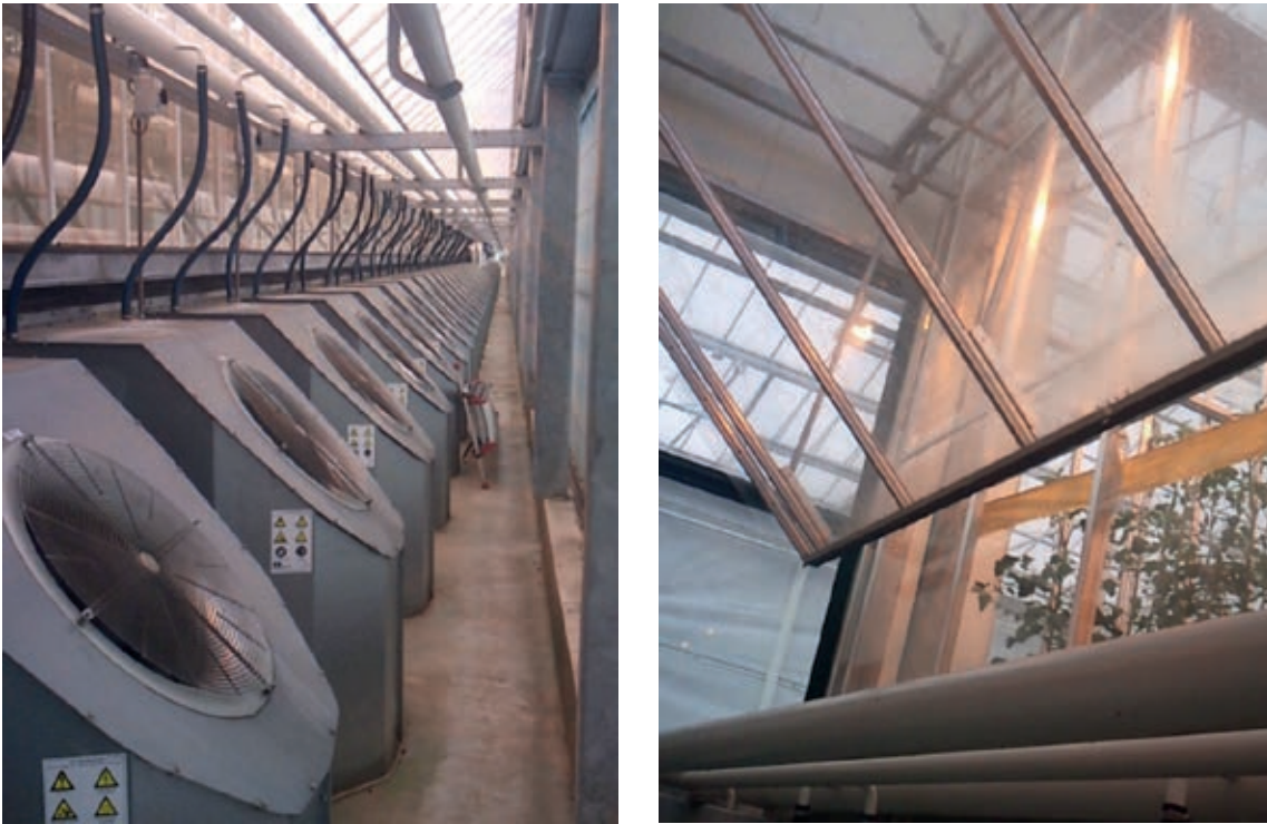
Figuur 8.2 Foto's van de luchtbehandelingskamer met ventilatoren. Rechts een detail van de klep die de verhouding buitenlucht/kaslucht bepaalt .
