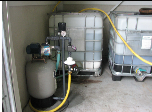
Reservoir en pomp
