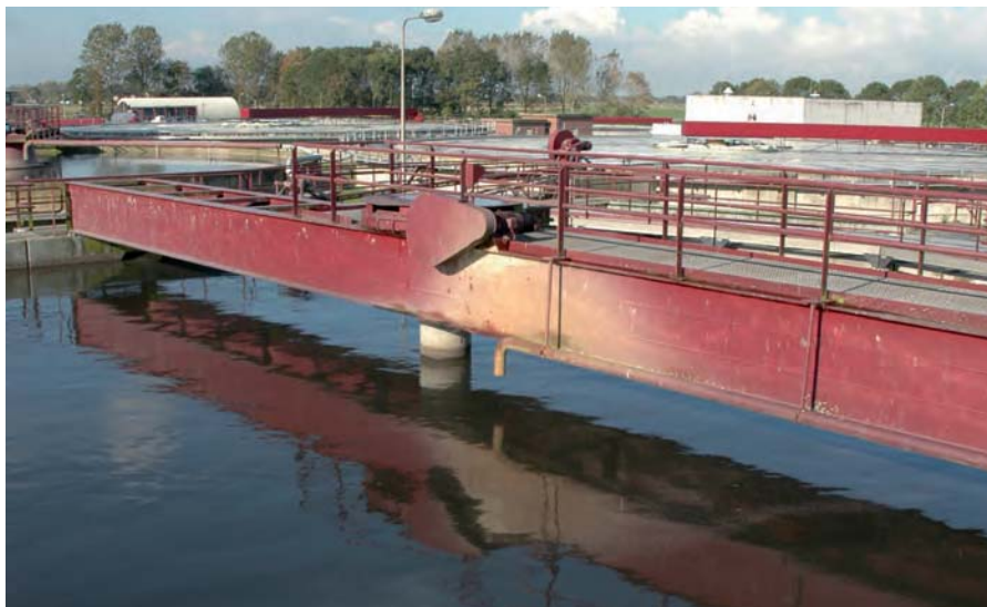
Een rioolwaterzuivering van Waterschap Noorderzijlvest (foto: Kees van der Mark)
