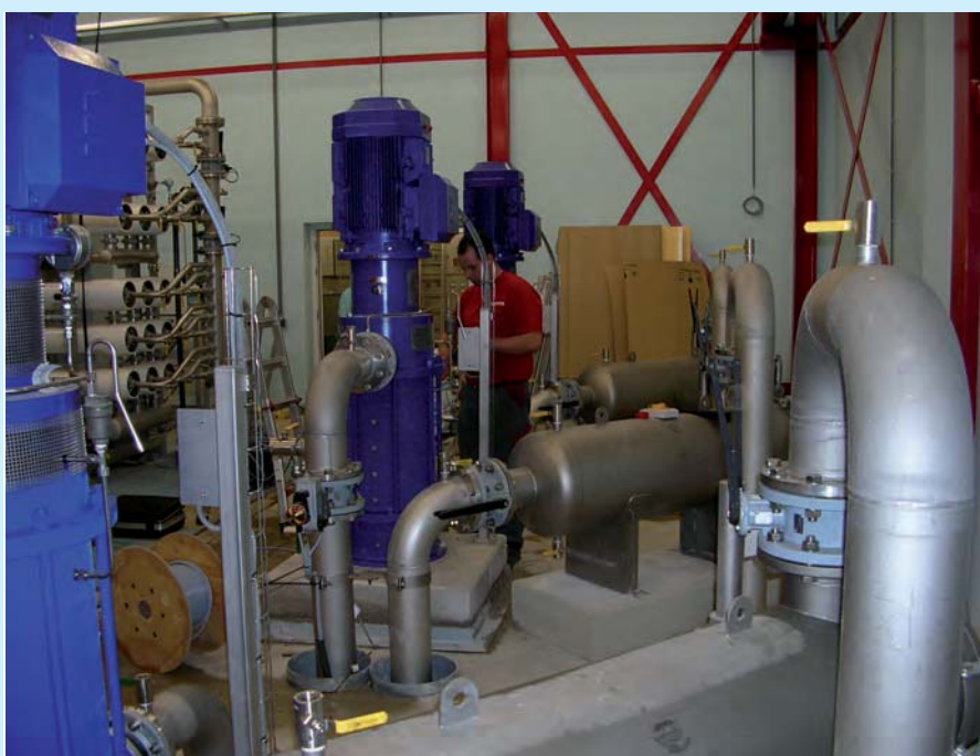
De full scale installatie van productiebedrijf Dinxperlo.
