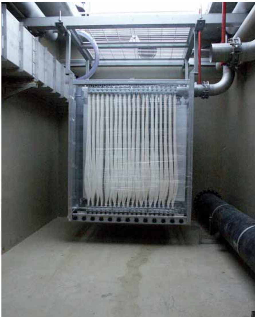
Een cassette in een membraantank (met rechtsonder de toevoerleiding en linksboven de afvoergoot).
