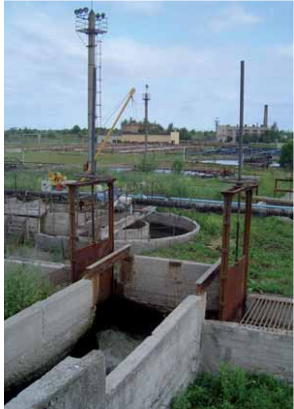
De waterzuiveringsinstallatie van Pskov (foto: Ton Swanenberg)
