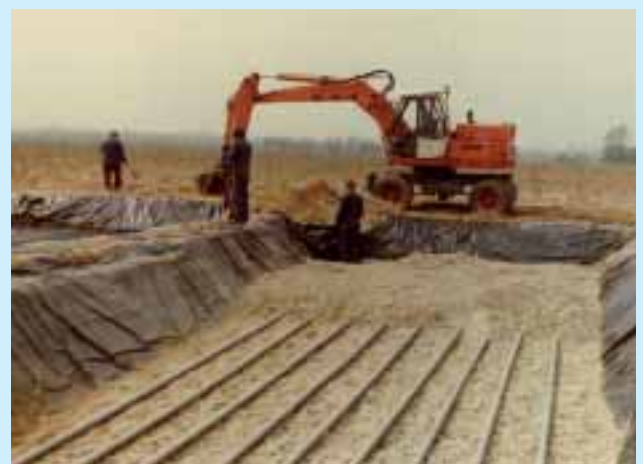
Het eerste bodemfilter voor stankbestrijding is in Nederland in 1978 aangelegd in Renkum. Voor de verdeling van de lucht werd een grindbed gebruikt waarop een doek werd gelegd voor ondersteuning van de compost.
