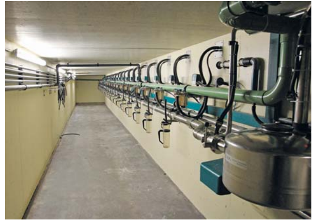
Leidingwerk, melkmeters et cetera zijn weggewerkt in de subway. Die is verwarmd: zo blijft de apparatuur vorstvrij. De verwarming dient meteen ook als vloerverwarming voor de melkers.
