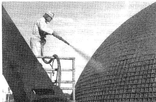
Bij de silo in Odiliapeel werd op de buitenzijde van de mal beton gespoten volgens de droge methode.
