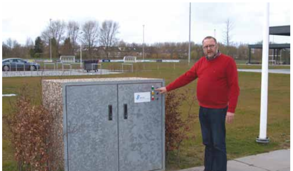
Joost Schuijs toont de bedieningskast van de pompinstallatie.
