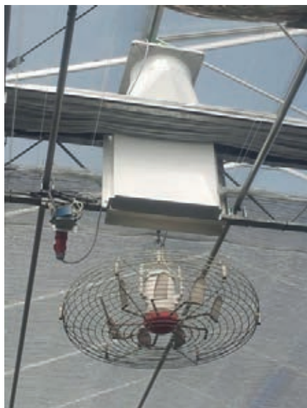
Figuur 1 Ventilation Jet bij Zuiderwijk Witzier.
