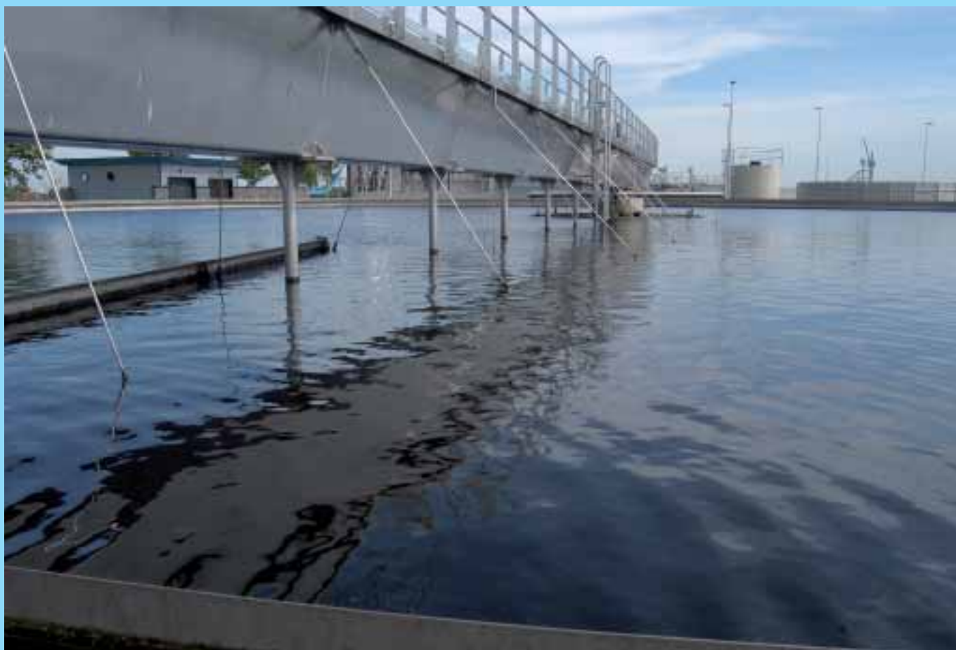
De rioolwaterzuiveringsinstallatie van Dedemsvaart.
