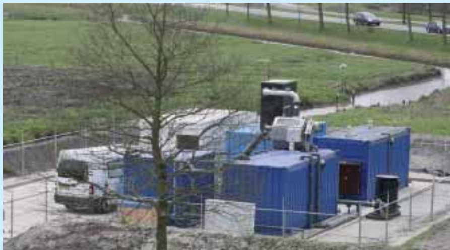
De containers in Sneek met de decentrale waterzuivering middels een compacte membraanbioreactor.
