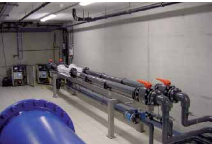
Buizenopstelling op zuiveringsstation De Laak.
