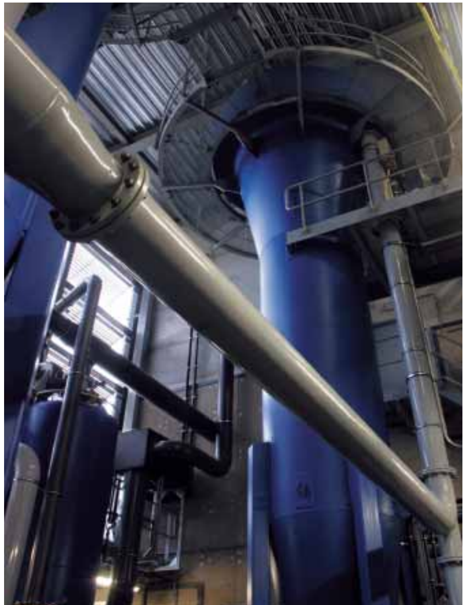
De onthardingsinstallatie van waterproductiebedrijf Nuland van Brabant Water.
