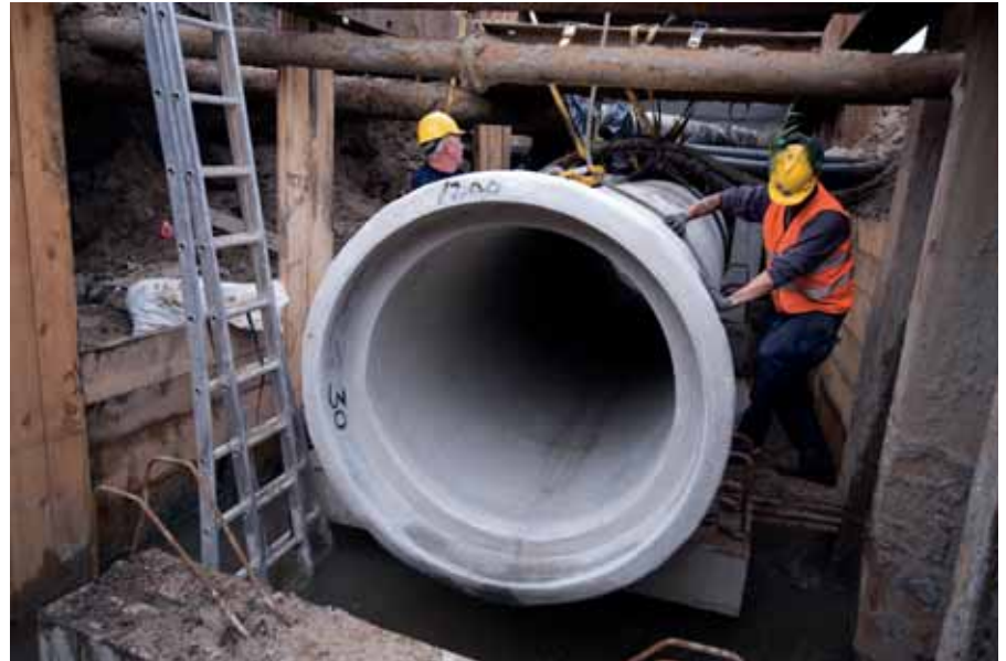
De rioolbuis wordt geplaatst op betonnen kespen die dragen op houten palen.
