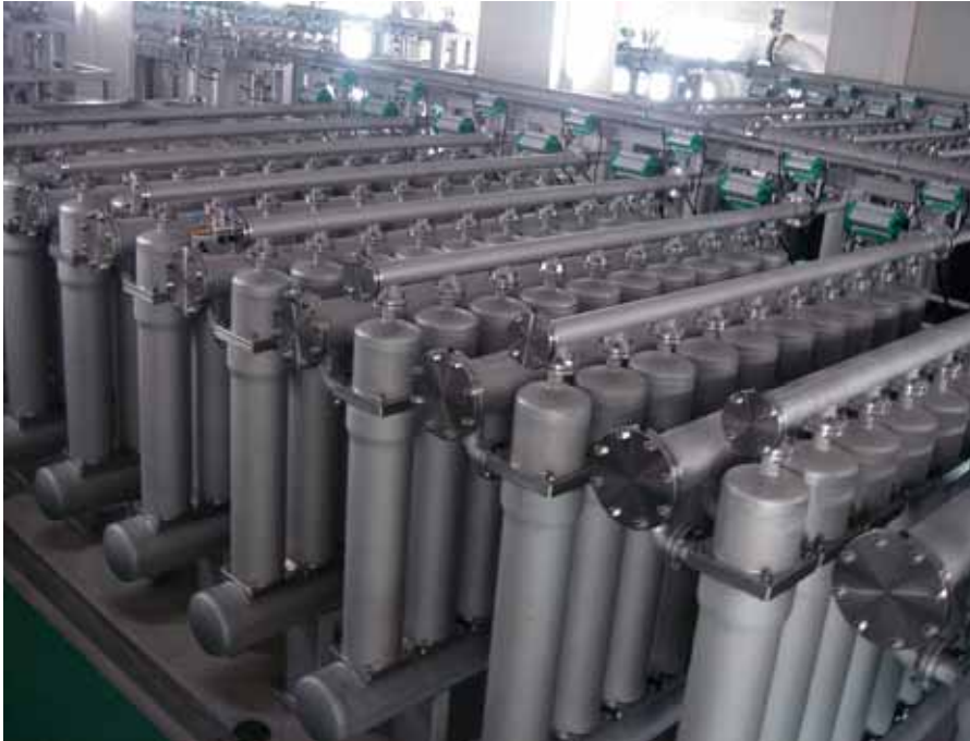
De drinkwaterzuiveringsinstallatie in Oshio.
