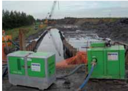
Break van een persleiding bij 's-Gravenpolder afgelopen september (foto: Waterschap Zeeuwse Eilanden).
