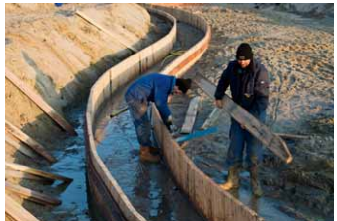
Guus Hummelink en Martijn Arfman van GMB bezig met de aanleg van een vistrap.
