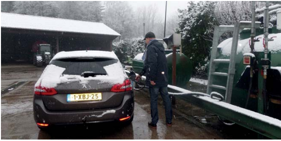
Beveilig brandstoftanks met een toegangs-sleutel en een registratiesysteem.
