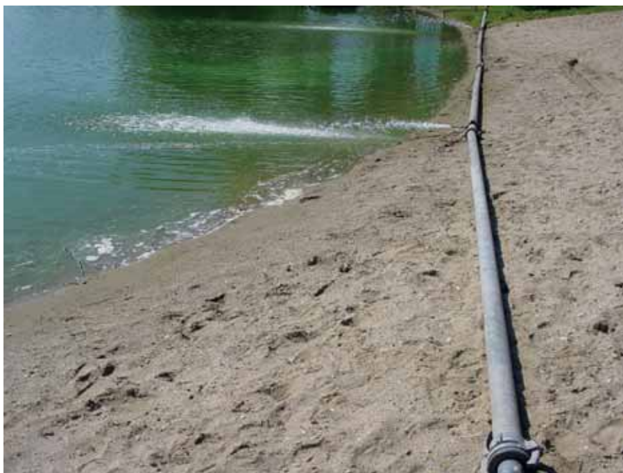
Irrigatie installatie Gouden Ham (foto: Cees Roffelsen).
