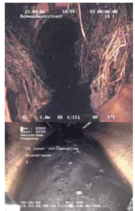
Inspectie van een polderriool: wortelgroei (boven) en zand- en vuilophoping (onder).
