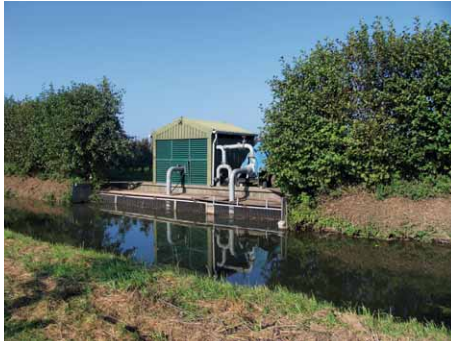
De pompen in het gebied hebben een capaciteit van 30 kubieke meter per uur per hectare om voldoende capaciteit te hebben voor berekening tijdens nachtvorst.
