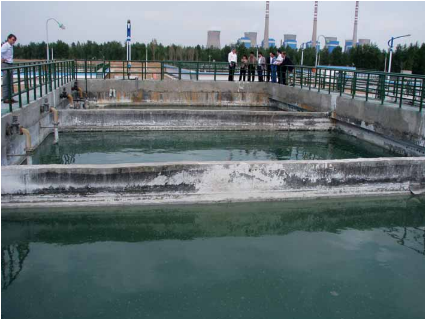
Een afvalwaterzuiveringsinstallatie van een petrochemisch bedrijf.
