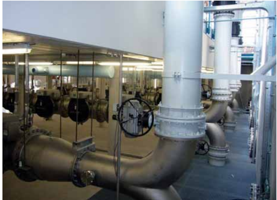
De UV/H 2 O 2 -installatie op productiebedrijf Lagrand.
