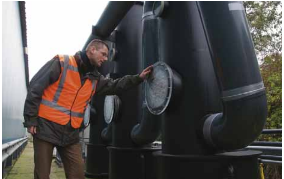
Martin Wilschut bij de stikstofwasinstallatie.
