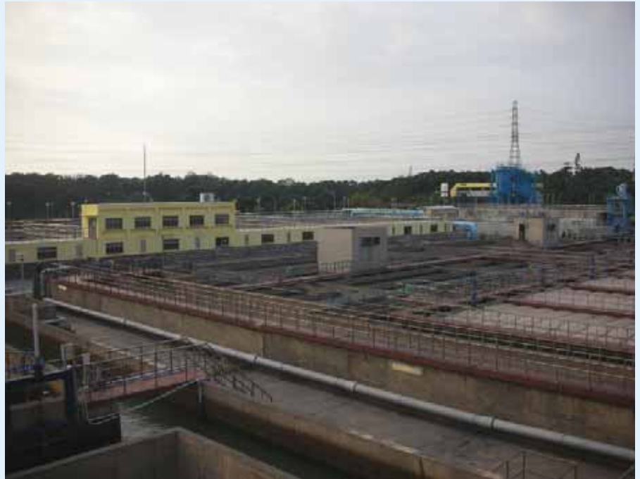
De zuiveringsinstallatie van Chen Chin lake.
