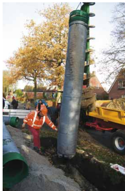
Gerard Staal plaatst de buis in het geboorde gat in de zandgrond.
