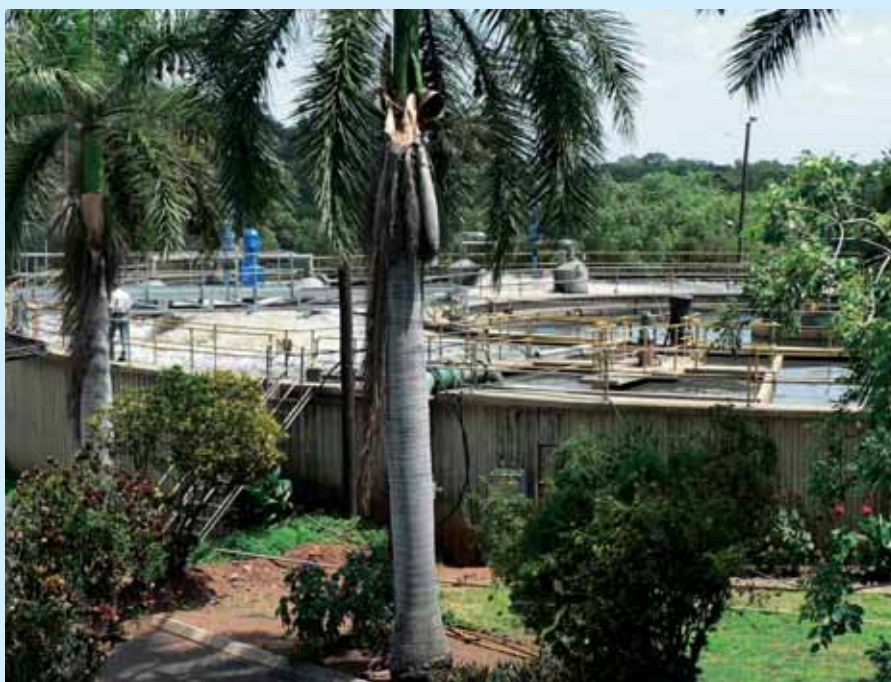
Een zuiveringsinstallatie in Phalaborwa (foto: Keimpe Sinnema).
