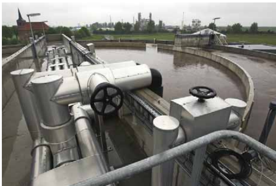
De zuiveringsinstallatie voor het zoute afvalwater van de bedrijven op Oosterhorn.
