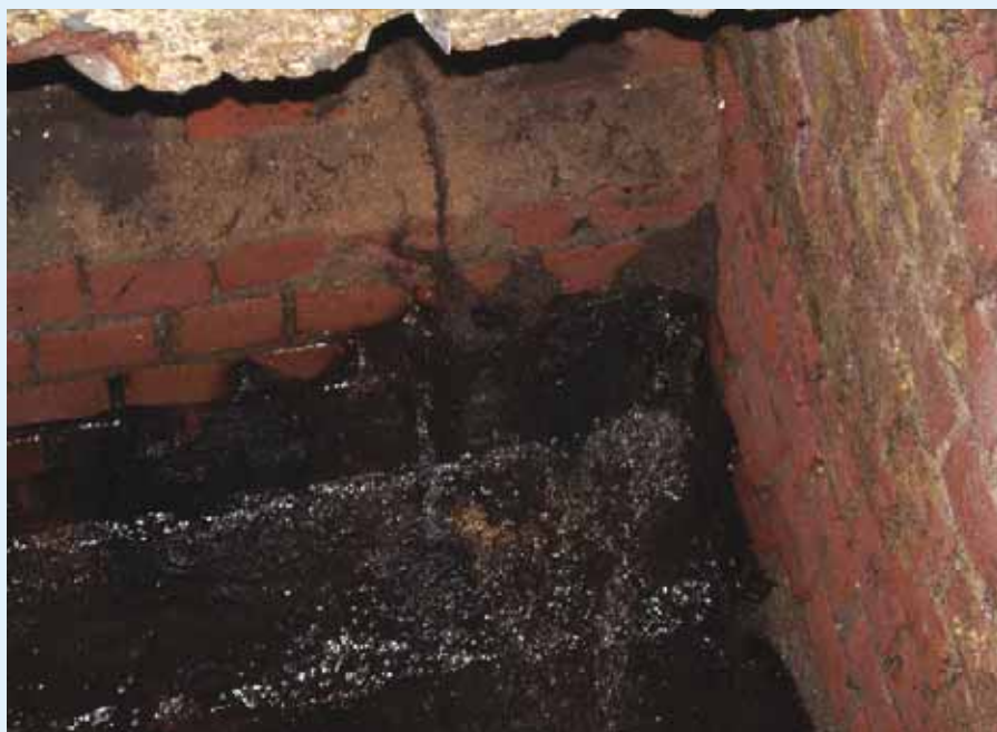
Lekke overstortmuur, waardoor oppervlaktewater naar binnen stroomt.
