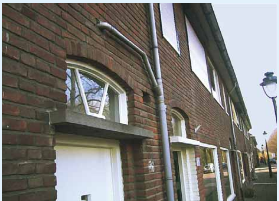
Een foutieve aansluiting van een badkamer op de regenwaterafvoer.
