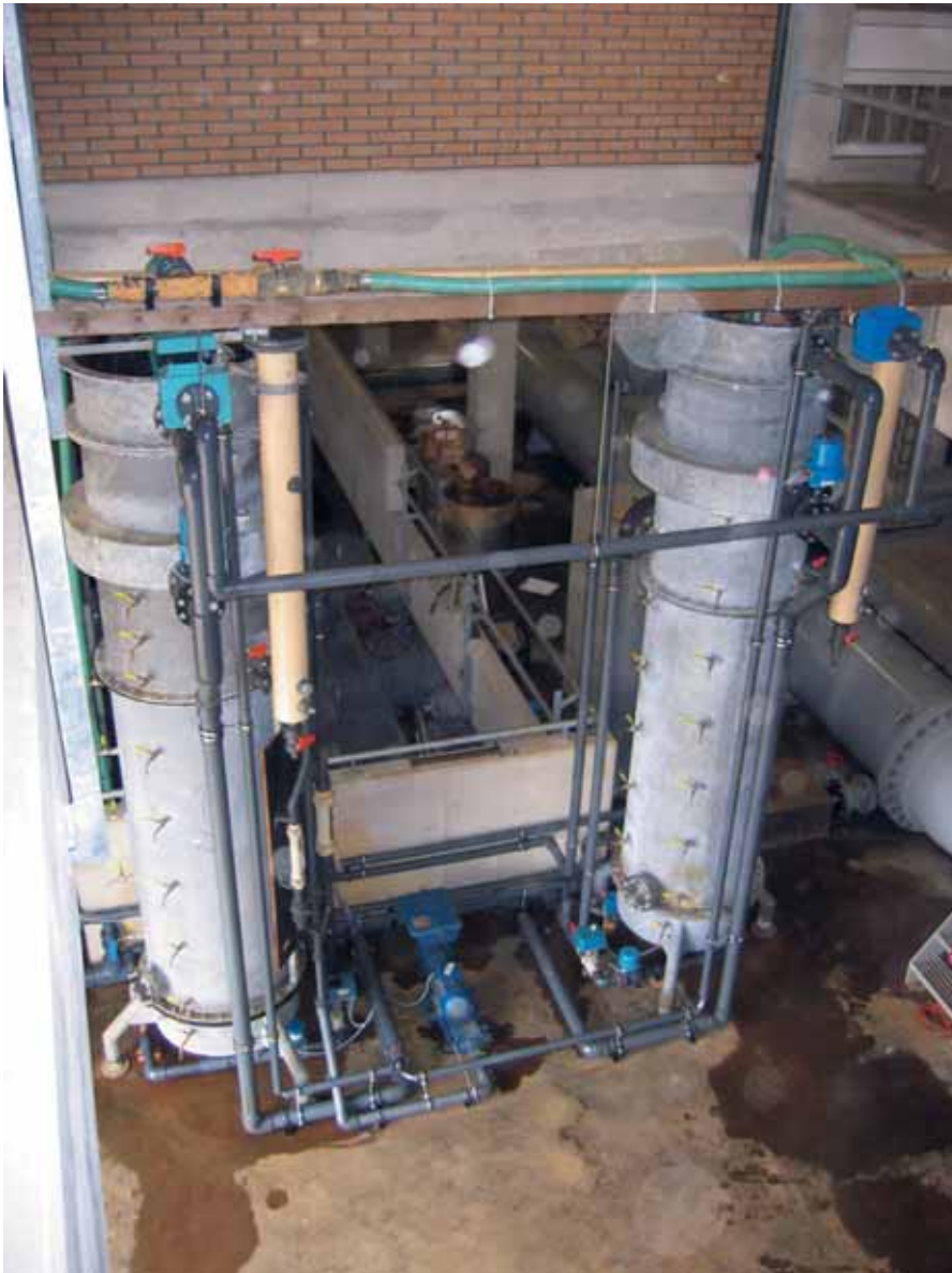
Proefinstallatie voor onderzoek naar optimalisatie van de voorzuivering op productiebedrijf Spannenburg.
