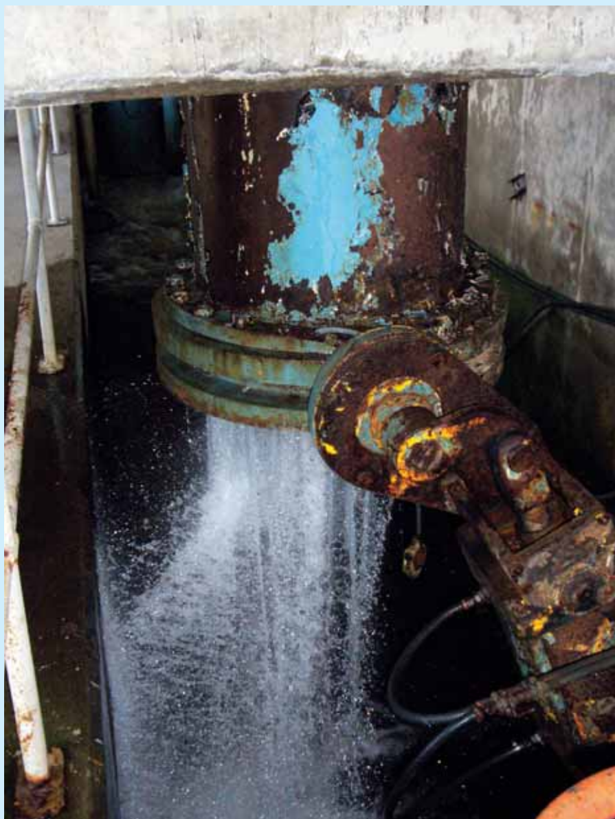
Continu lekkende spoelwaterkleppen.
