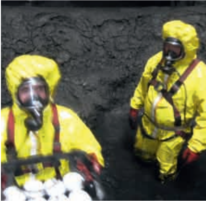
In de buffertank met uitgestigt slib op rwzi Amsterdam-West trof men zo'n 150 ton struviet aan.
