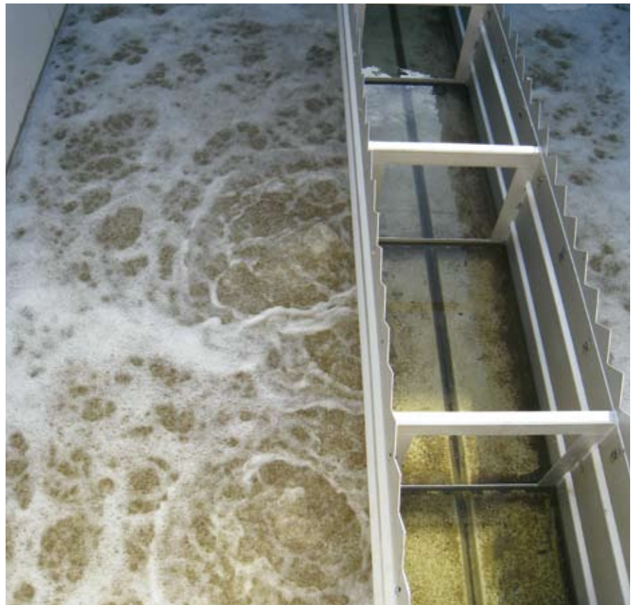
Bovenaanzicht discontinu zandfilter (in terugspoelfase).
