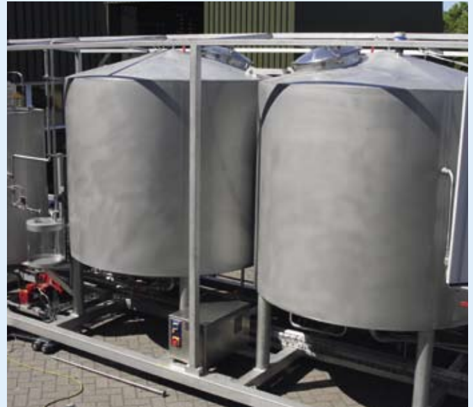
Pilotinstallatie met thermische hydrolyse en vergisting.
