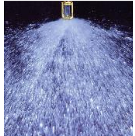
Sprinklerkop in bedrijf.
