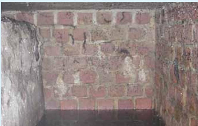
Vrije ruimte boven de overstortdrempel is te beperkt.
