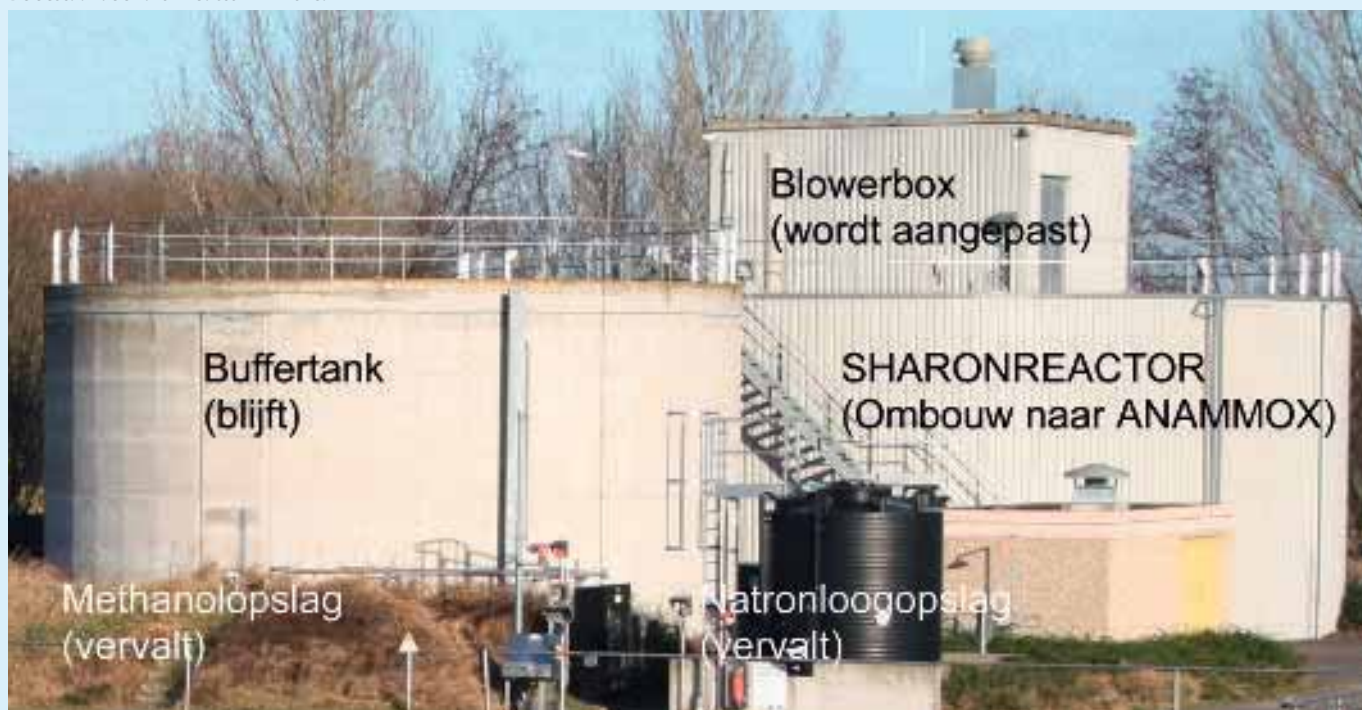
De bestaande Sharon-reactor in Zwolle.
