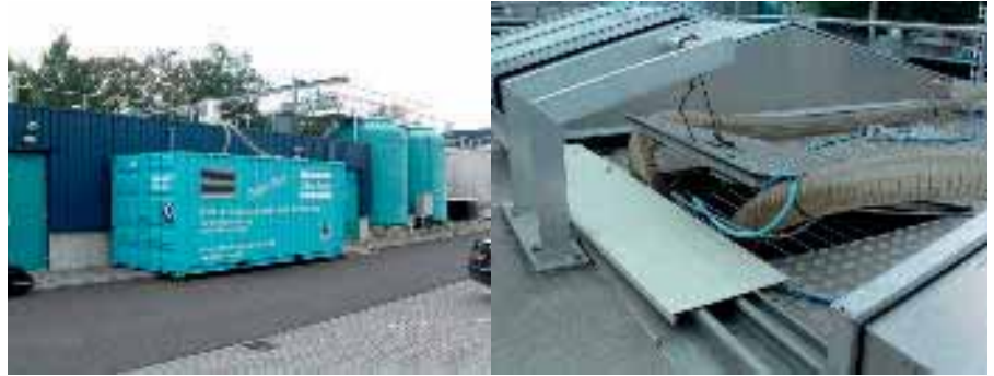
Opstelling blower (van Atlas Copco) en luchtaansluitingen membraanstraat 4.
